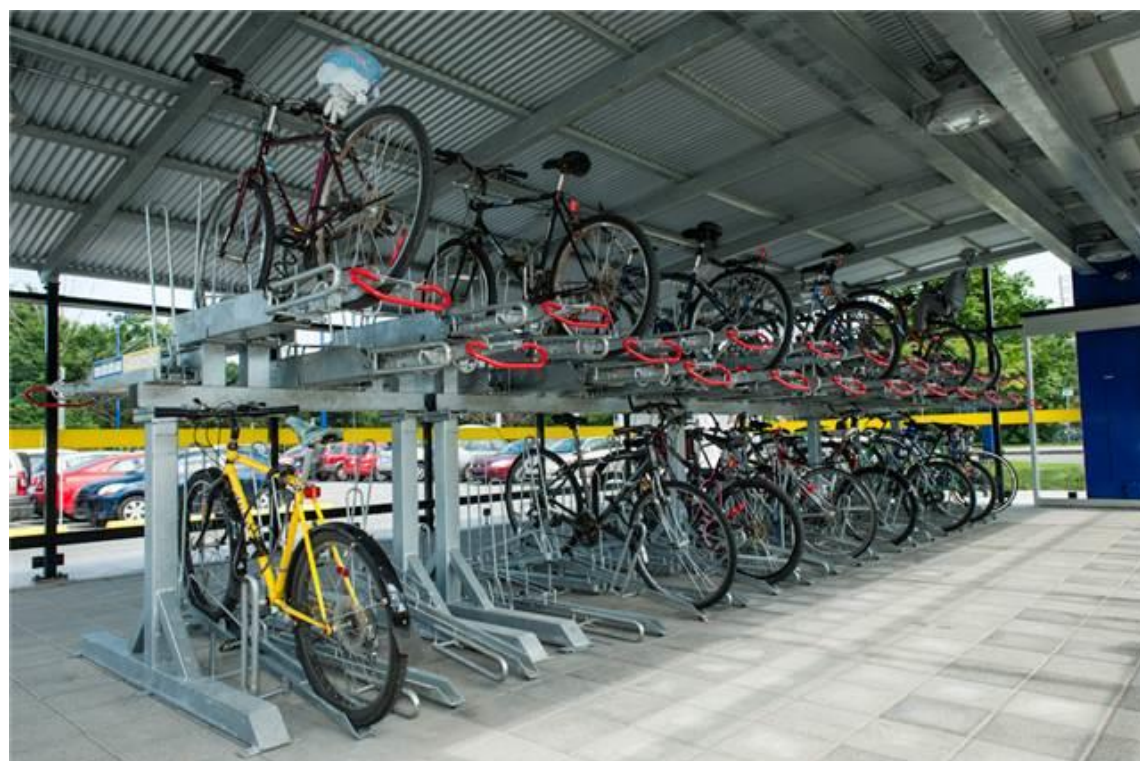
Les supports à vélo sont disposés sur deux étages à l'intérieur de la Vélostation.
