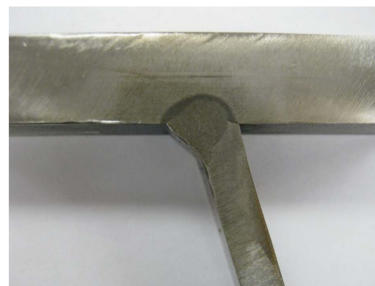
Soudure à pénétration partielle 80% entre la nervure et la plaque de tablier
