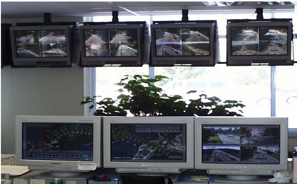
Figure 12 : Système de gestion centrale des voies réversibles, Vancouver, Colombie-Britannique
