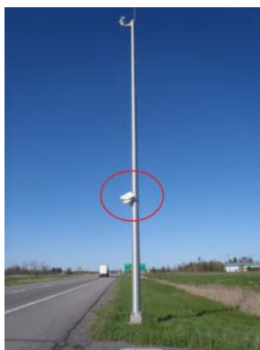
Figure 8 : Installation des capteurs non intrusifs à un endroit critique du réseau routier
