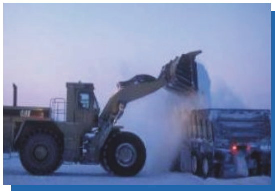
FIGURE 3-3 : Chargement et transport d'agrégats sur le versant nord de l'Alaska (avec l'autorisation de l'AIC)
